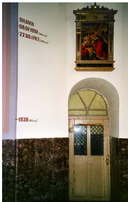
Glatz, Markierungen der Hochwasserstände in der Minoritenkirche
